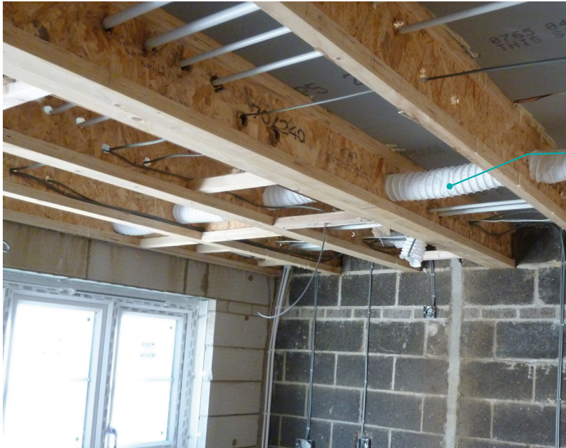
conducto flexible demasiado largo
